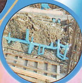
ท่อส่งน้ำประปา
